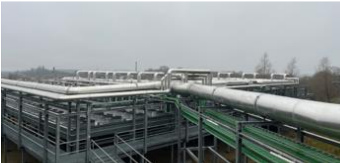
Figur 2: Svendborg Fjernvarmes varmepumpeanlæg, Bodøvej, som vil kunne forsynes med el fra det ansøgte VE-projekt
